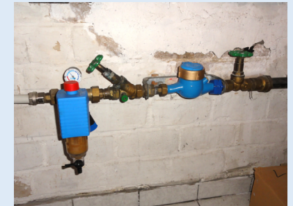
Abb. 5 Hausinstallation, Armaturengruppe mit Wasserzähler und -filter
