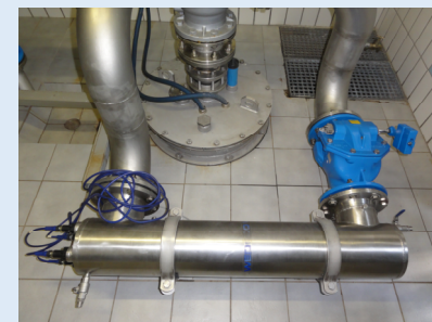
Abb. 2 UV-Desinfektionsanlage unmittelbar neben einem Brunnenkopf
