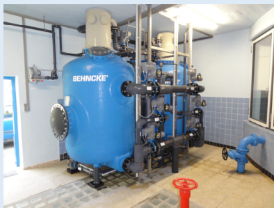
Abb. 3 Filterkessel zur Entsäuerung, Enteisenung und Entmanganung
