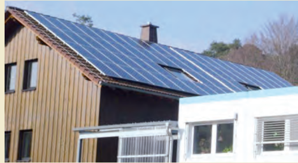
Fotovoltaikanlage auf den Deponiegebäuden beim Abfallwirtschaftsbetrieb (AWB) Limburg-Weilburg in Beselich.
