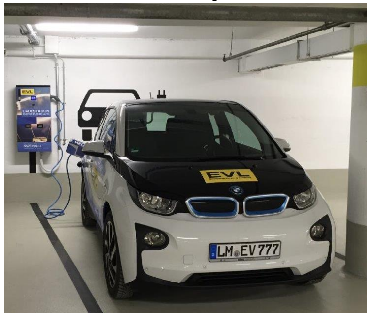
Abb. 19: Ladesäule im Parkhaus Westliche Altstadt
