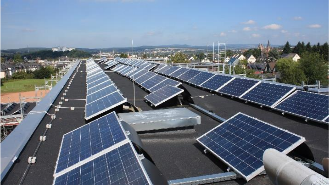
Abb. 15: PV-Anlage auf dem Dach der Goethe-Schule in Limburg
